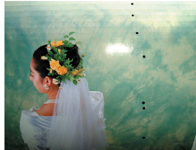
3. GOTEJAMENTO DE TINTA
